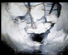
Tubería de Concreto colapsada
