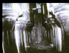
Reactor CRDM Inspección en soldadura
