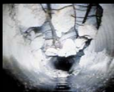
Tubería de Concreto colapsada
