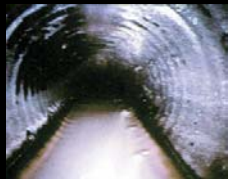
Servicio en Línea de agua - Inspección de referencia
